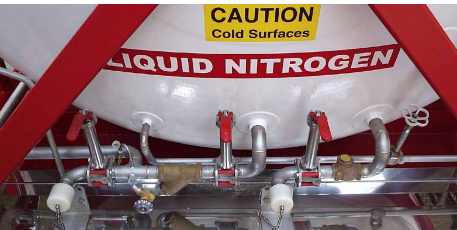
Криогенные вентили, установленные на передвижных резервуарах
